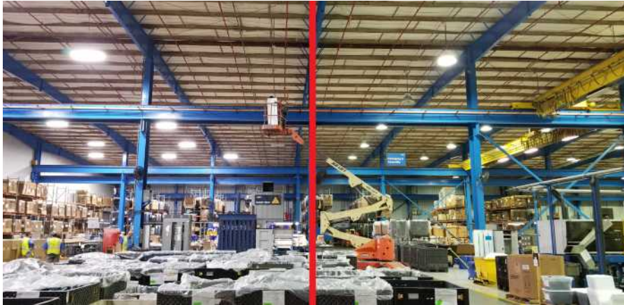
Vergleich der neuen LED-Beleuchtung (links) und der alten Induktionsbeleuchtung (rechts) bei GF Harvel in Little Rock.
