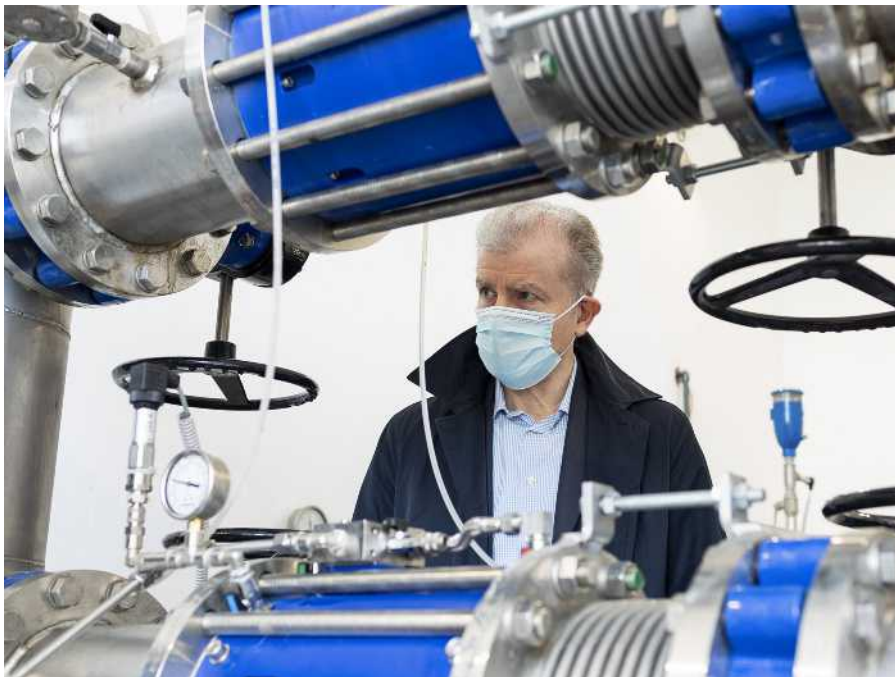
Marco Alberti, Verkaufsleiter bei GF Piping Systems Italien, überprüft doppelte Druckregelventile zur Steuerung der nachgeschalteten Druckregulierung.
