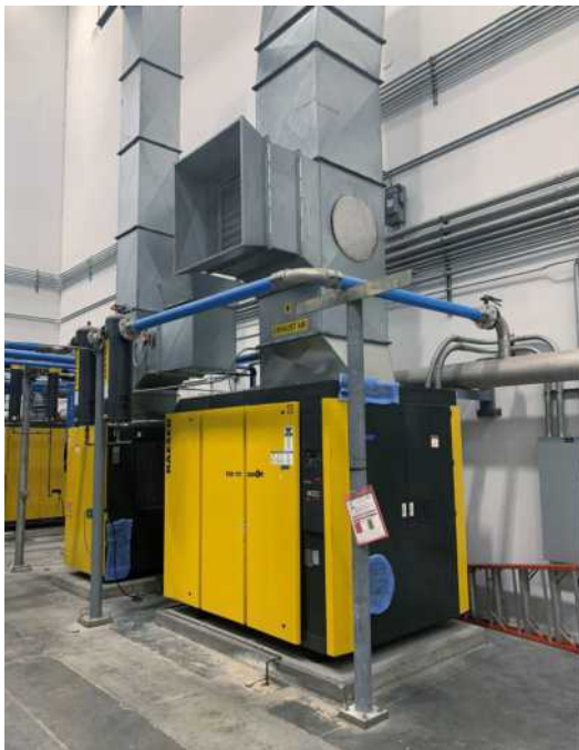
Neuer Wärmeabzug eines Luftkompressors bei GF Linamar in Mills River.
